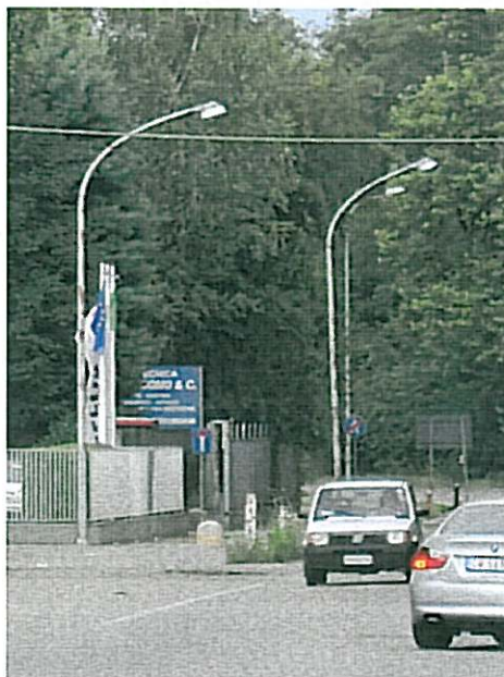
Apparecchi stradali in via Papa Giovanni XXIII. Installazione su palo con sbraccio. Lampada a vapori di mercurio a bassa efficienza. Apparecchio con basso rendimento e dispersione di flusso luminoso verso l'alto.
