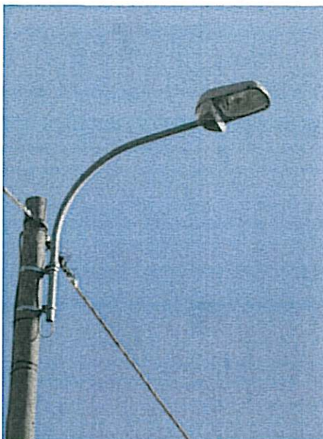
Apparecchio stradale che rispetta la LR 17/2000. Installazione con sbraccio su palo in CAC.
