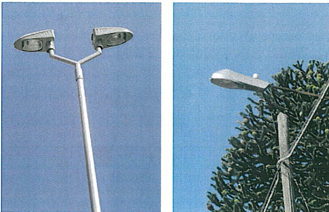
A sinistra apparecchi conformi alla L.R. 17/2000; a destra apparecchio fuori norma.
