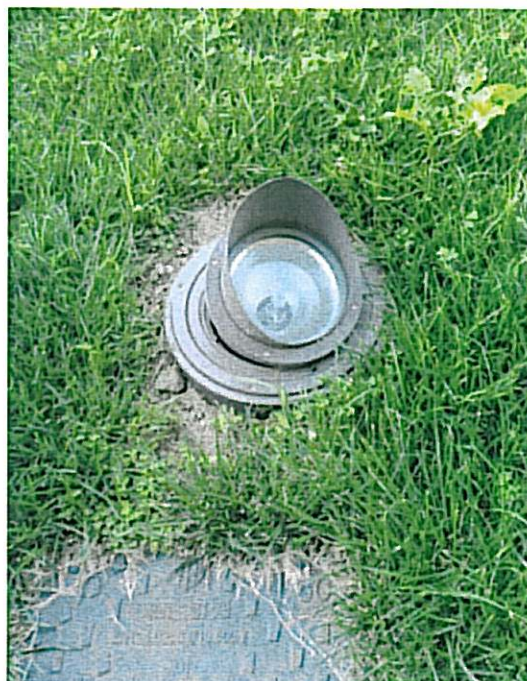
Apparecchio a proiezione ad incasso per illuminazione emergenza architettonica. Lampada ad alogenuri metallici con buona efficienza luminosa. Flusso luminoso emesso verso la volta celeste, ma in parte all'interno della sagoma dell'edificio.
