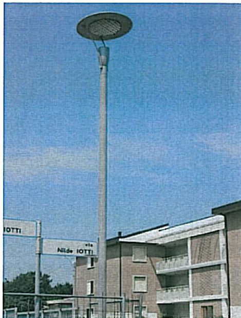
Apparecchio da arredo urbano a luce indiretta. Impianto recente con lampada ad alogenuri metallici ad alta efficienza. Apparecchio con rendimento non ottimale e dispersione del flusso luminoso verso l'alto.
